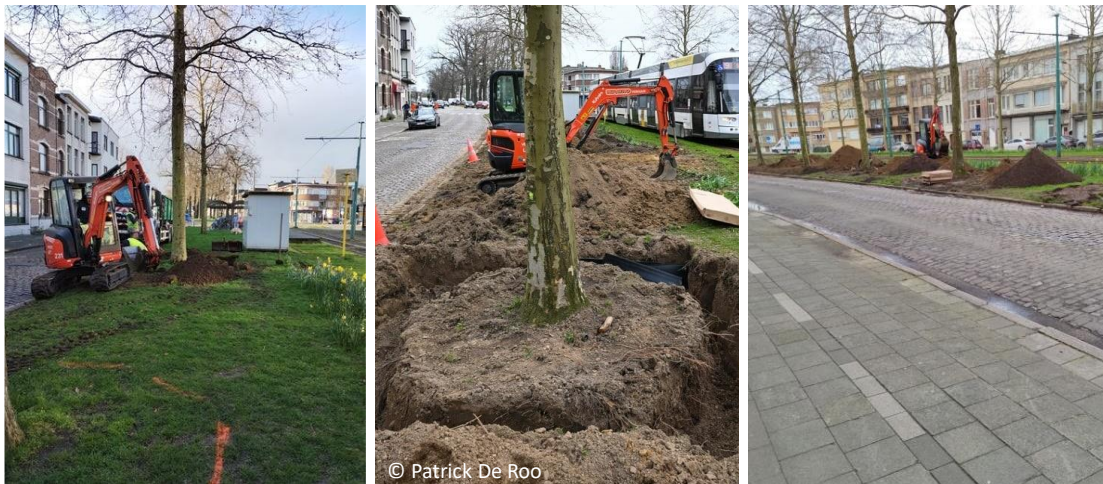
Figuur 26 – Foto's genomen in maart 2023. De wortels van de hoogstammige bomen op de Boekenberglei werden zonder pardon doorgezaagd ter voorbereiding op een verplanting i.k.v. dit dossier.
