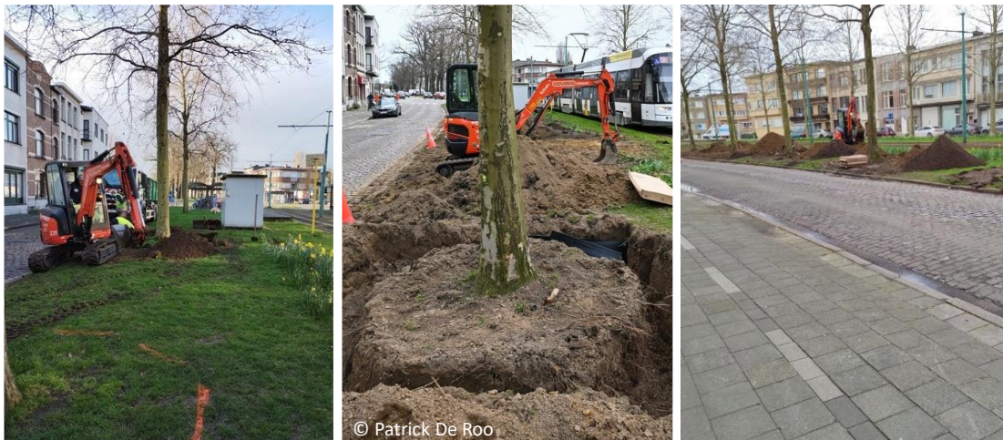
Figuur 37 – Foto's genomen in maart 2023. De wortels van de hoogstammige bomen op de Boekenberglei werden zonder pardon doorgezaagd ter voorbereiding op het verplanten in het kader van dit dossier.
